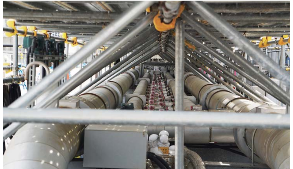
遮水壁の冷媒配管—中央下のバルブの上に白い氷が見える。常時冷却している。
