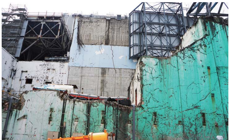
建屋表面の多数の傷は、津波が引く際に流された瓦礫が付けた傷
