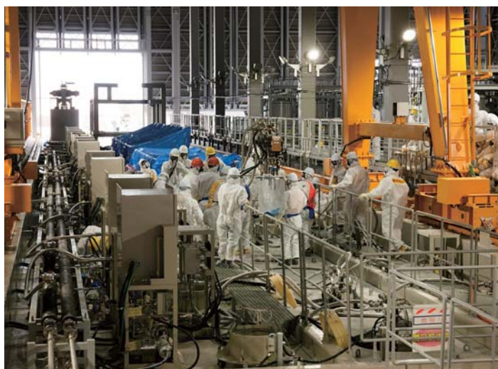
増設ALPS内部－750トン／日の処理能力（TEPCO）
