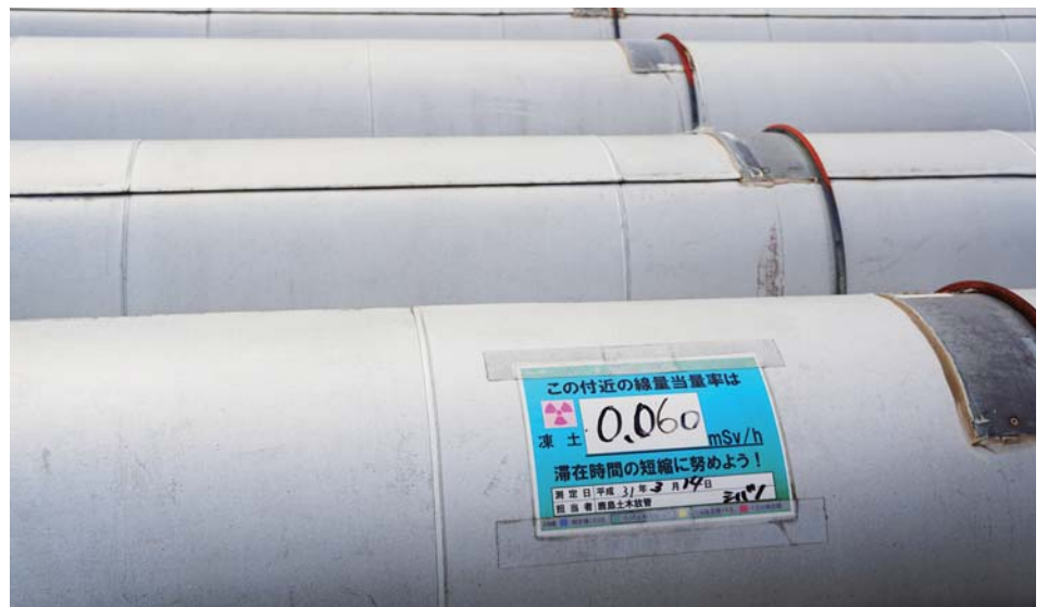
遮水壁用の冷媒液が流れる配管。配管にもこの付近の放射線量が表示。
