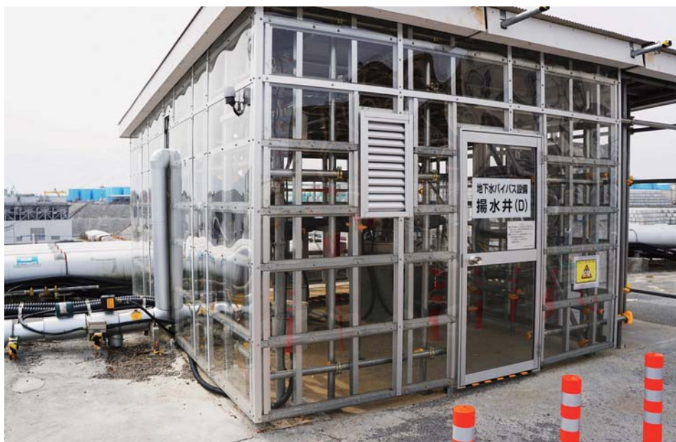
建屋横の地下水汲み上げ井戸
