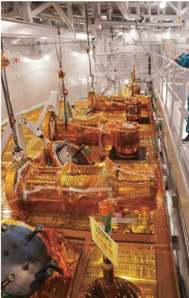
機器の保管にはビニールシートが掛けられ、十二分の注意が図られている
