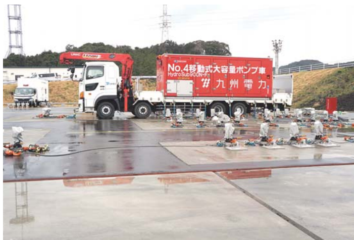
可動式大容量ポンプ
