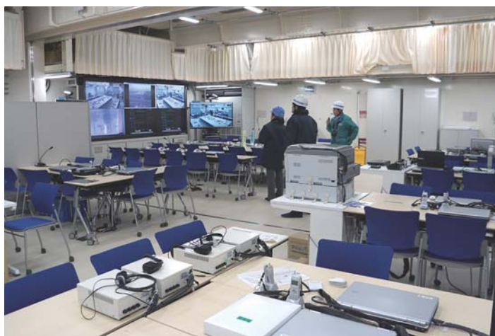
緊急時対策所内部
