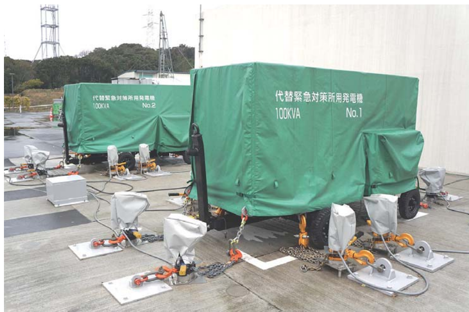
緊急時対策所用発電機
