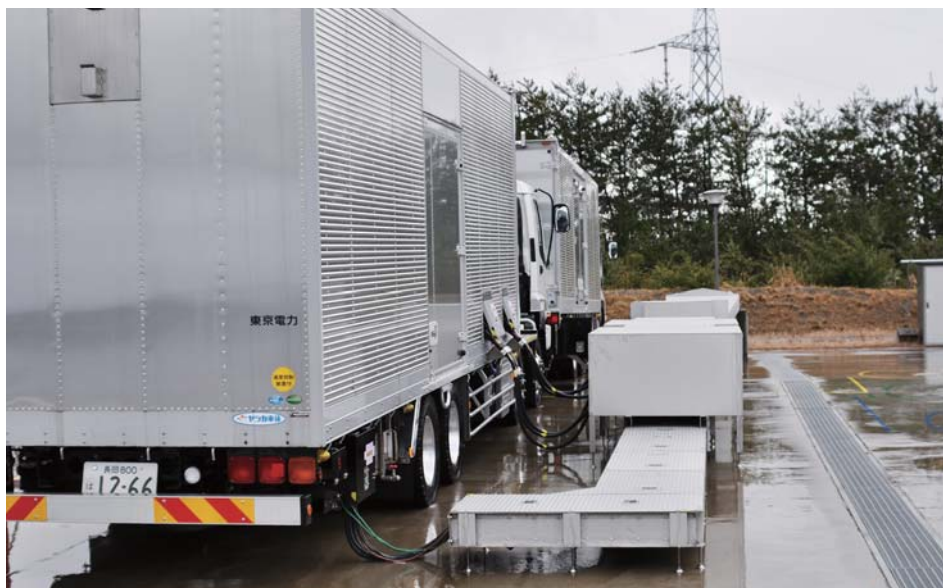
高台に備え付けられた高電圧のガスタービン電源
