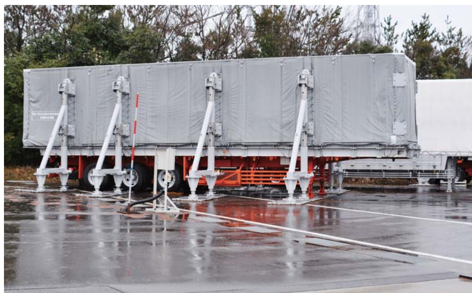
トレーラーの中に熱交換器とポンプ
