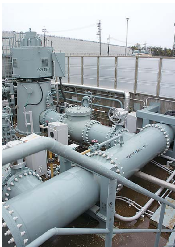
海水取水ポンプと新設された防水壁
