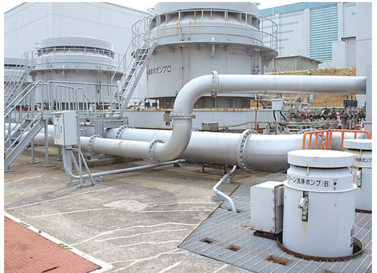
循環水ポンプ：タービンから出てきた蒸気を水に戻す復水器のための海水冷却ポンプで、海水が被ったままになっている。おそらく取り替えないと使えない。
