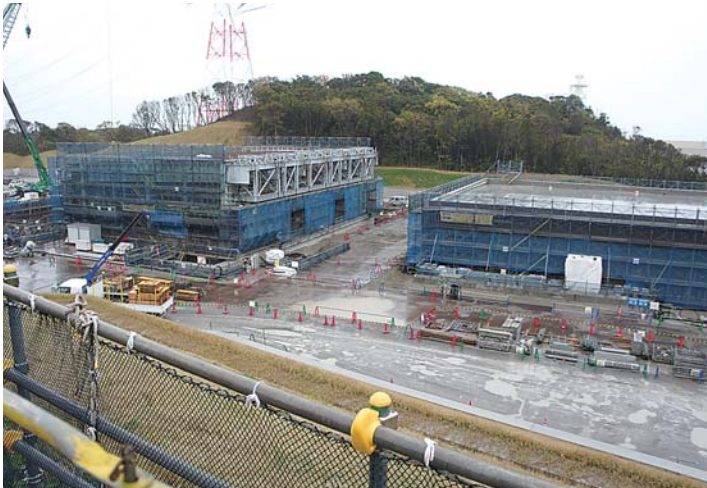
左がガスタービン発電機建屋、右が電源盤・配電盤建屋
