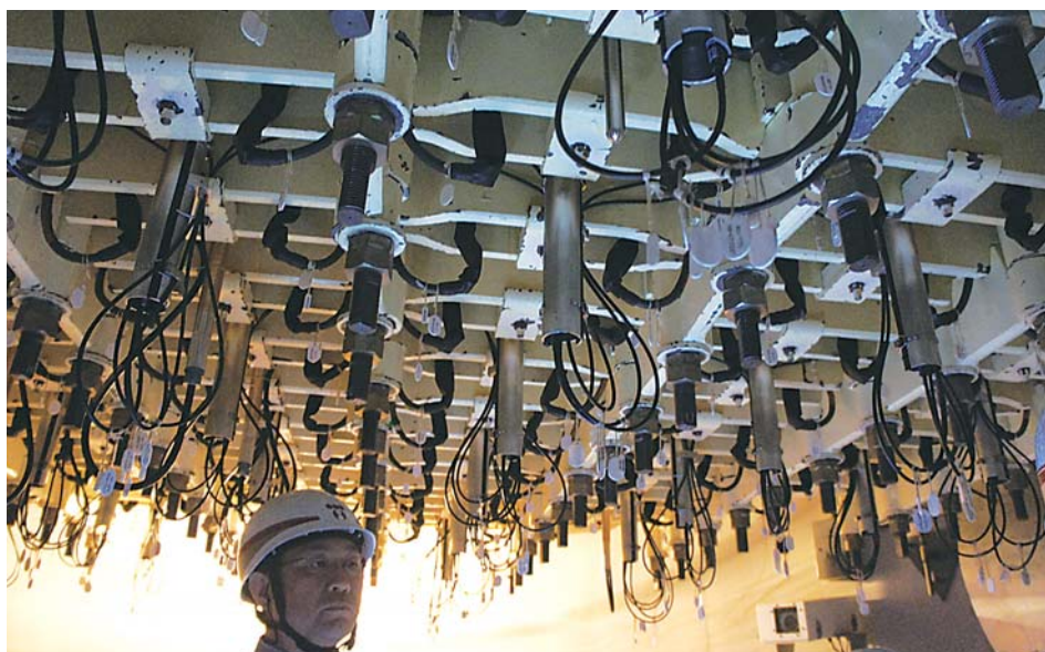
3号機原子炉圧力容器の真下。原子炉の核分裂を止める制御棒や計測機器の末端が出ている。冷温停止状態では、圧力容器の真下まで視察できる。
