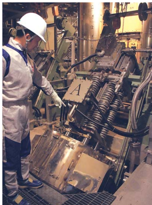
巨大な主蒸気隔離弁、格納容器内側に4弁、外側に4弁付いている。
