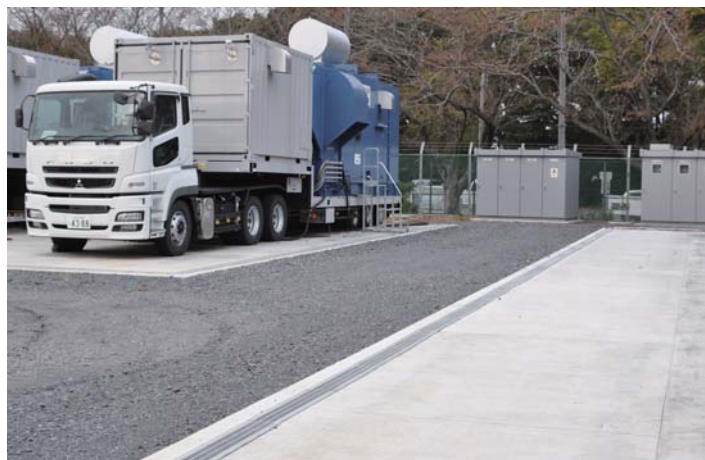
空冷式大容量高圧電源車 (5台)
