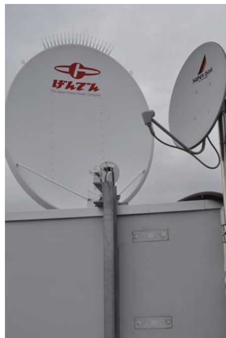
緊急時対策室建屋屋上の パラボラアンテナ
