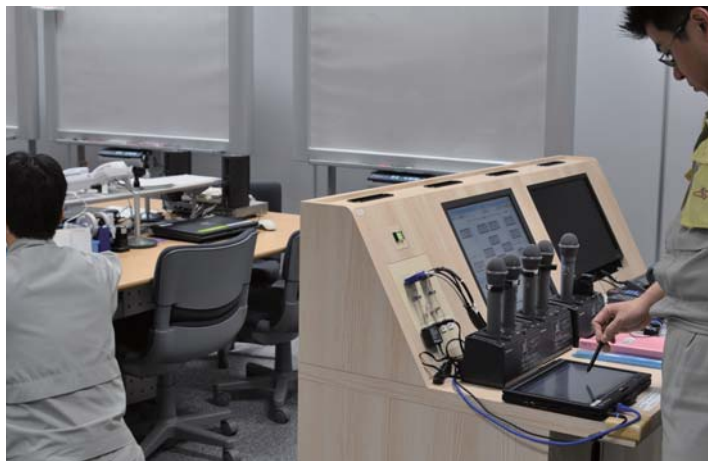
緊急時対策室
