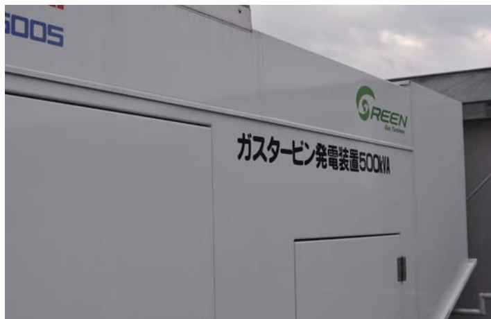
緊急時対策室建屋上の緊急用自家発電機
