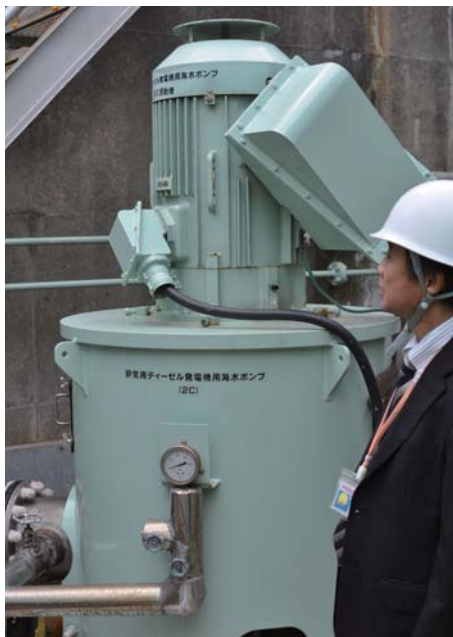
冠水した海水ポンプ (2C) 分解掃除して6日後に復旧
