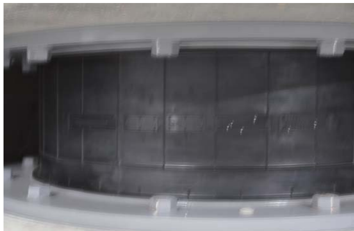
緊急時対策室建屋地下の免震ゴム（地震ではありません、撮影時の手ぶれです）
