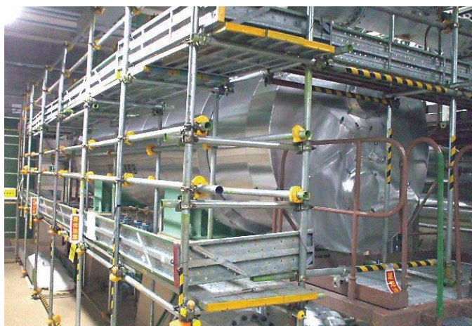
横長の熱交換器のちょうど半分まで海水が進入 (東北電力提供)
