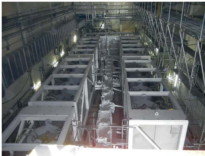
循環注水冷却系装置
