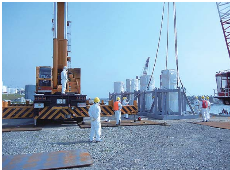
セシウム高性能吸着装置の陸揚げ
