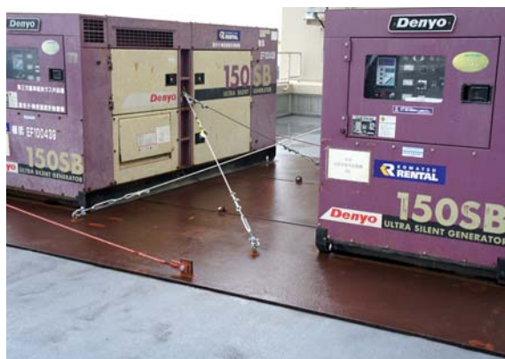
4号機の災害対策用発電機
