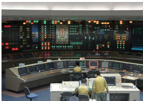
運転停止中の5号機の中央制御室
