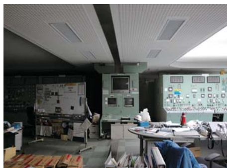
3号機の中央制御室が先に通電
