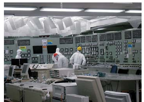
1、2号機の中央制御室
