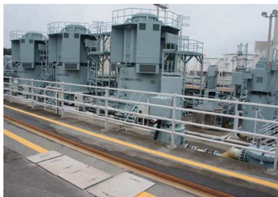
4号機の海水循環ポンプ
