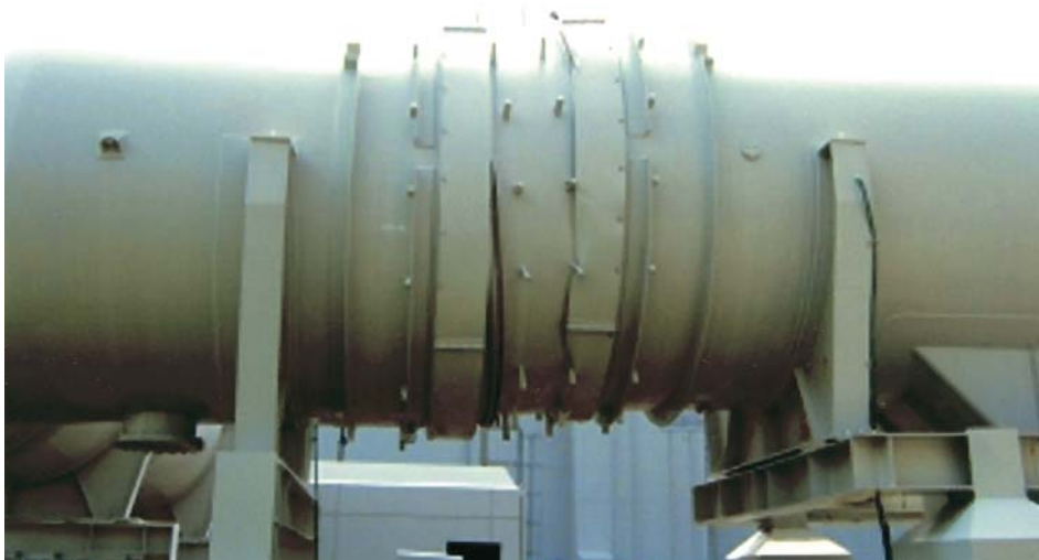
3号機ダクトのズレ
