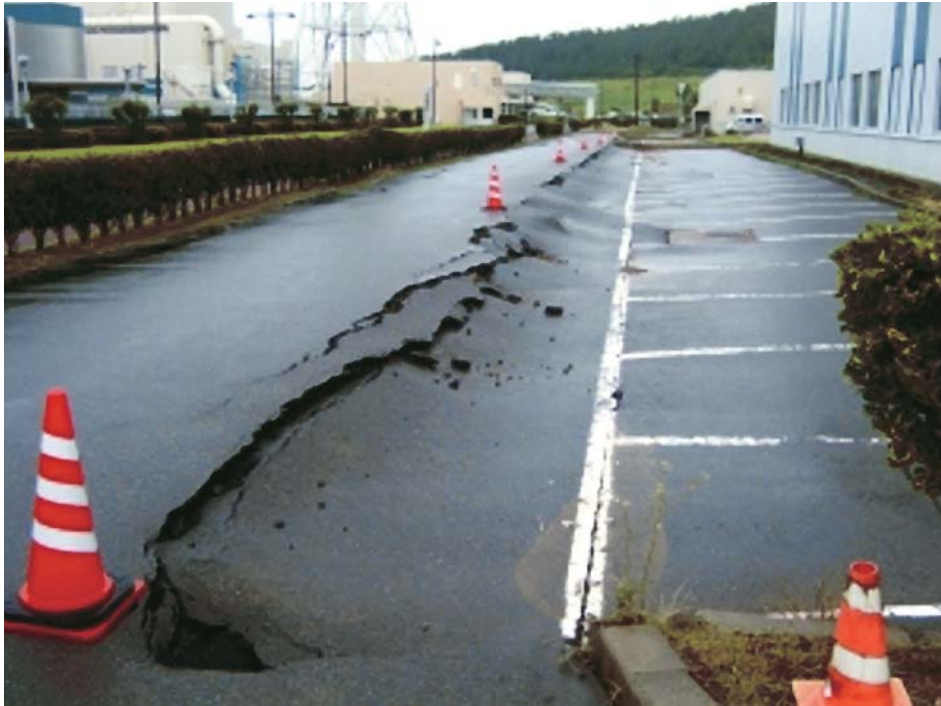
所内の道路に亀裂
