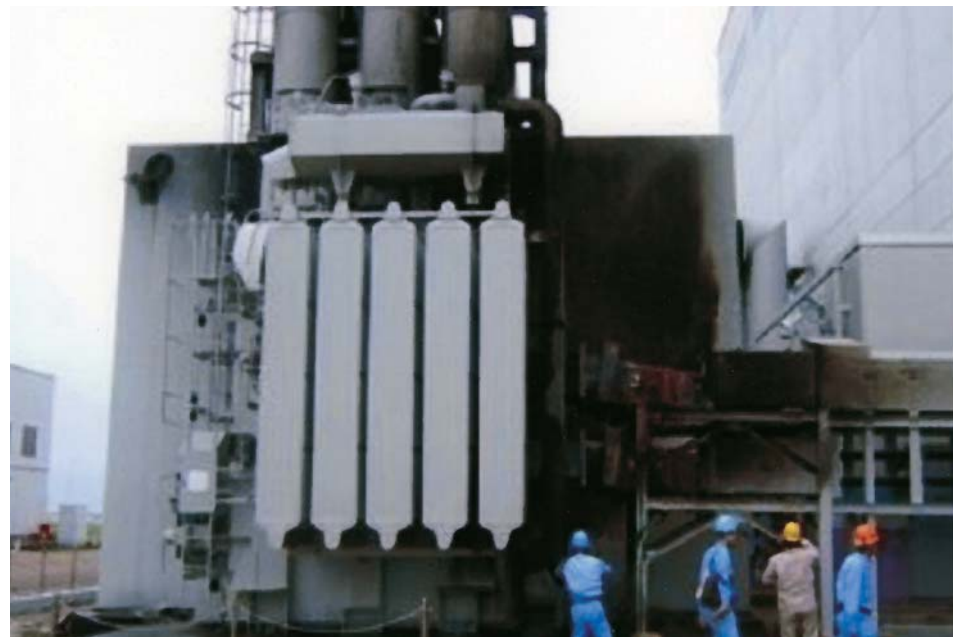
3号機変圧器火災跡（右側黒い部分）
