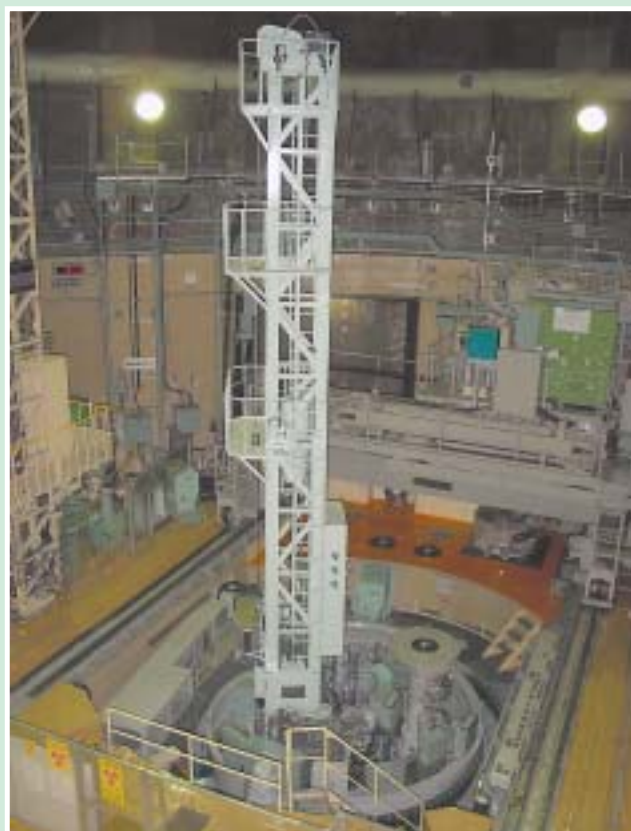
燃料交換機が取り付けられた「常陽」の炉上部
