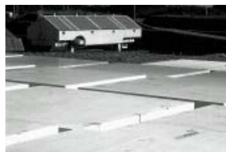
5,000本入りのコンクリートピットが並ぶ1号埋設施設
