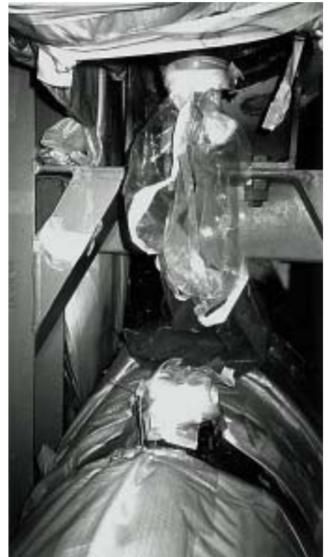
一次冷却水が漏洩したU字管のあった所(切断部:再生熱交換器 敦賀2号機)
