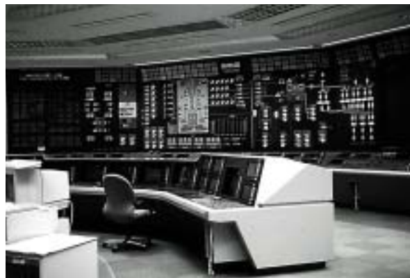
第3世代の中央制御盤（6号機）
