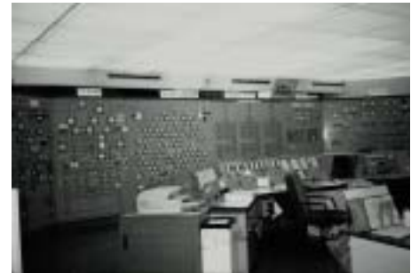
クラシックな雰囲気の中核発電所の中央制御室
