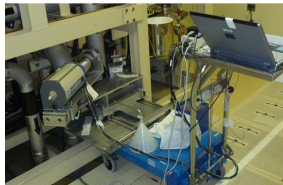
配管濃縮度モニター(*1)
